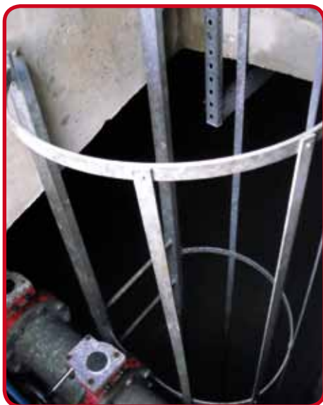
La crinoline bloque l'accès à l'échelle et nécessite un enjambement hasardeux. Les arceaux sont trop espacés, les plats filants sont fixés à l'extérieur des arceaux
