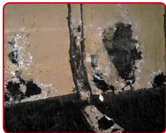
Feuille multicouche très dégradée
