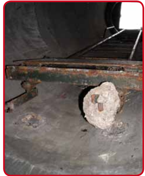
Échelle descellée en partie basse
