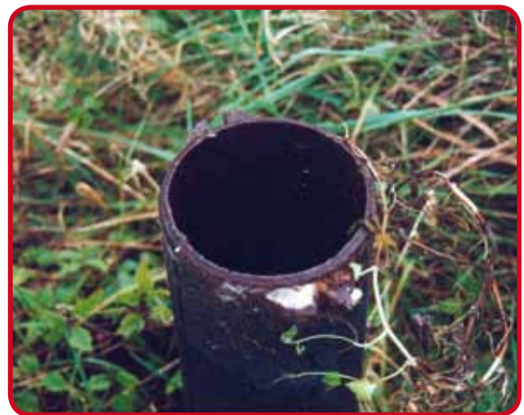
Cheminée d'aération sans son chapeau
