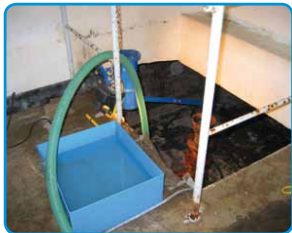
Pédiluve rempli de solution désinfectante
