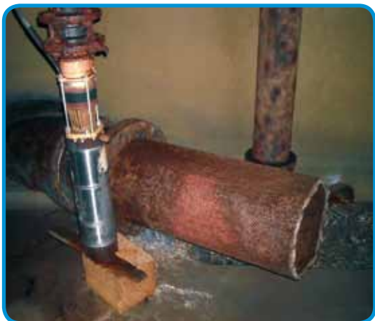
Entretien régulier, corrosion légère (mais présence d'une cale en bois...)
