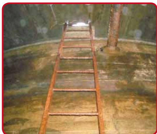
Échelle vétuste, aucune protection
