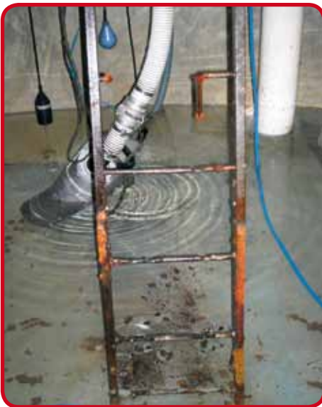
Corrosion extrême en partie basse de l'échelle
