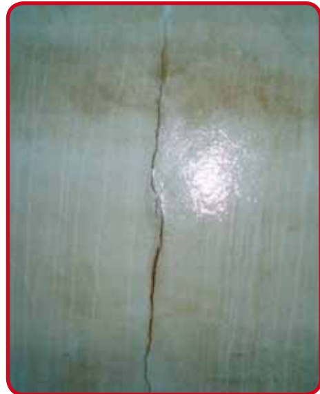
Fissure retenant les dépôts de fer
