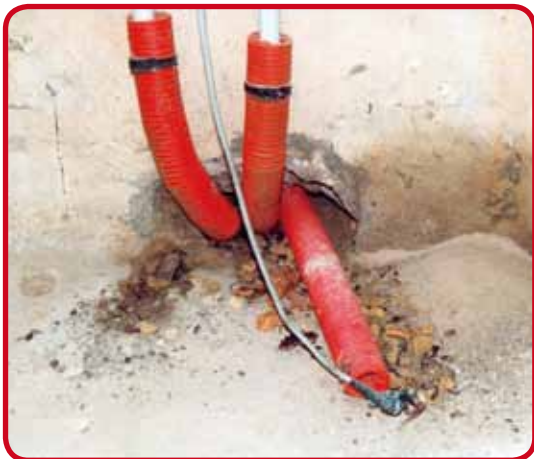
Traversée de paroi exécutée sans soin
