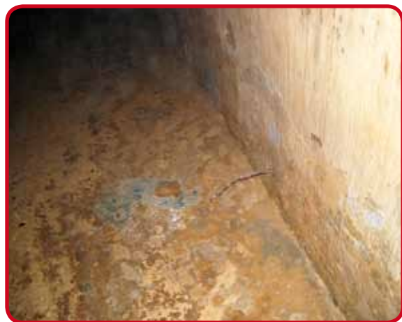
Entrée d'eau dans la cuve
