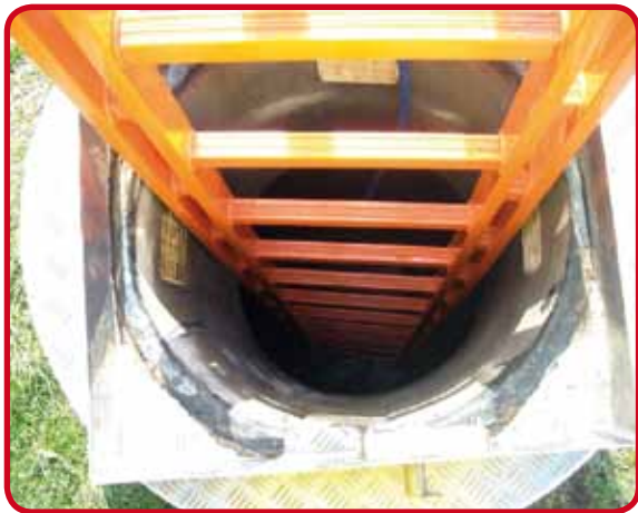
Trappe d'accès trop étroite, sans échelle fixe
