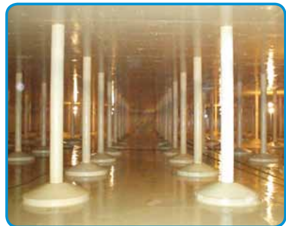
Réservoir entretenu, nettoyé et désinfecté régulièrement
