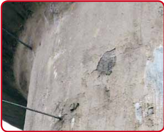
Revêtement ciment dégradé
