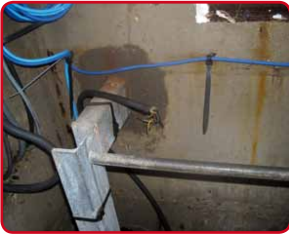
Câbles électriques sectionnés à portée de main
